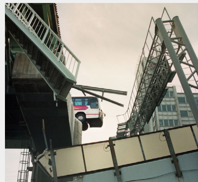
阪神高速道路が崩壊し、転落しそうな観光バス（下）
